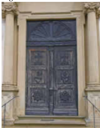
Die Kirchentüre am westlichen Hauptportal der Wallfahrtskirche soll repariert werden.
