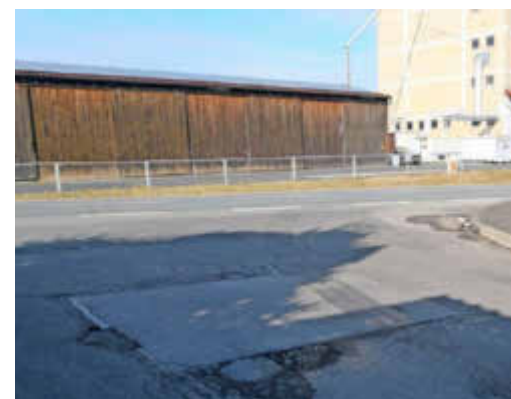
Die Einfahrt der Frühlingsstraße in Prosselsheim ist stark abgefahren.
