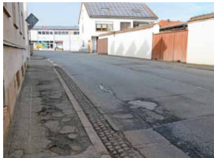
Die Schäden auf dem Gehsteig und der Würzburger Straße in Prosselsheim sind unübersehbar. 50.000 Euro sollen im Haushalt 2026 für den Unterhalt der gemeindlichen Straßen und Wege eingestellt werden. Fotos: Irene Konrad
