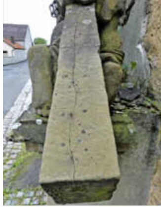
Vor der Renovierung waren die Schäden am Bildstock wie Risse deutlich zu sehen.
